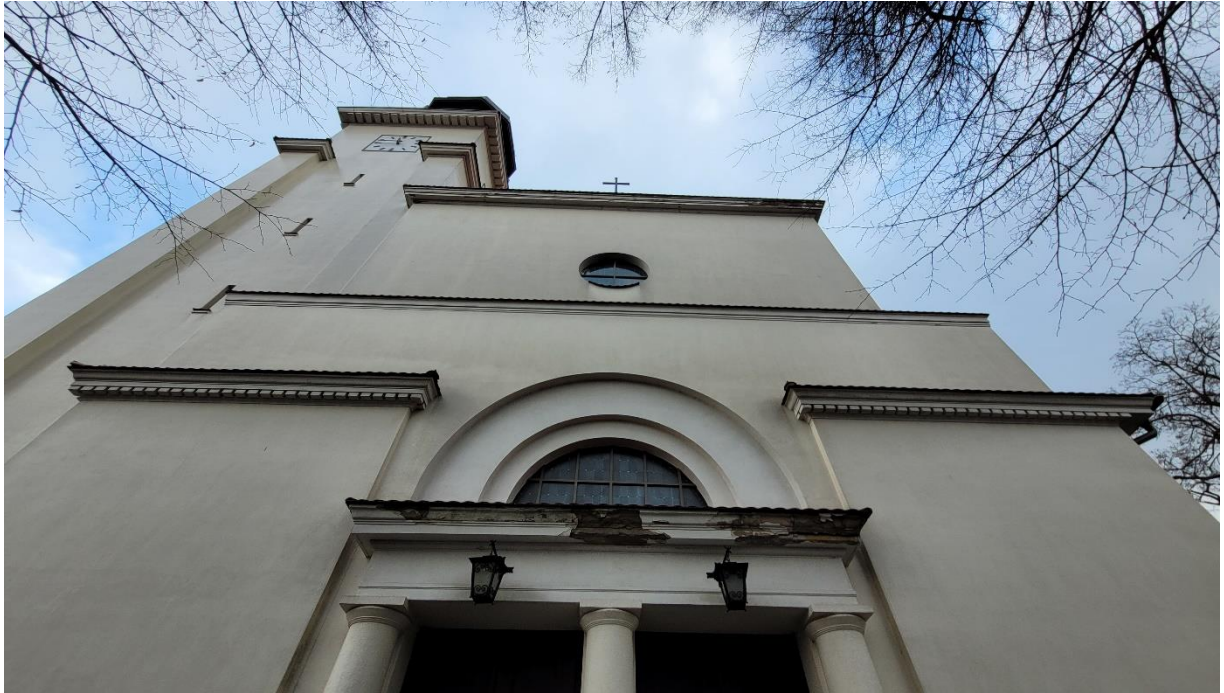
Fot. 3 Gzyms do remontu
