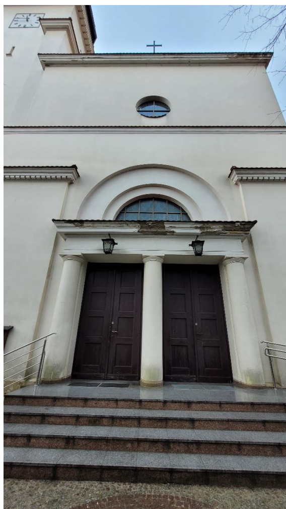
Fot. 2 Gzyms do remontu, kolumny do oczyszczenia
